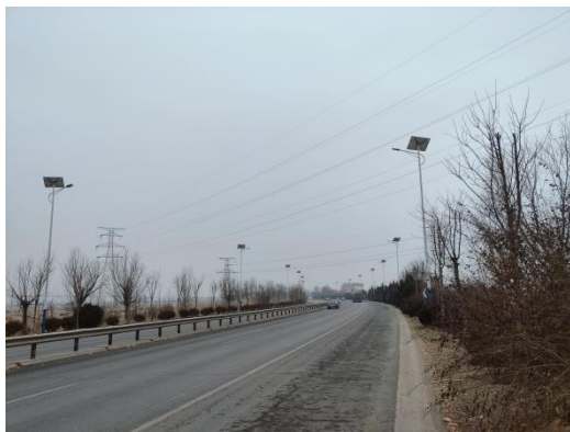
图 4-12 跨越国道 G240 处(14#-15#杆塔)
