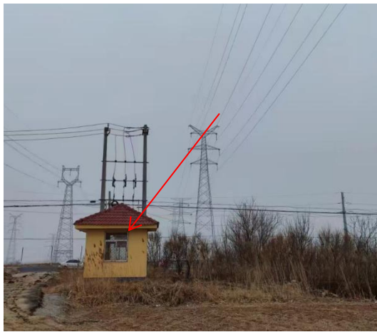
5.苦水马庄村东北角的配电房
