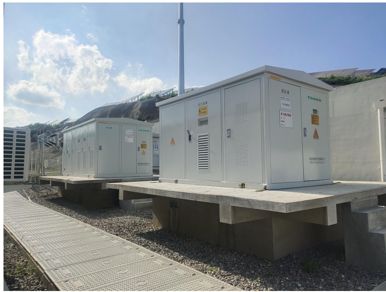
图 7-5 站内变压器室
