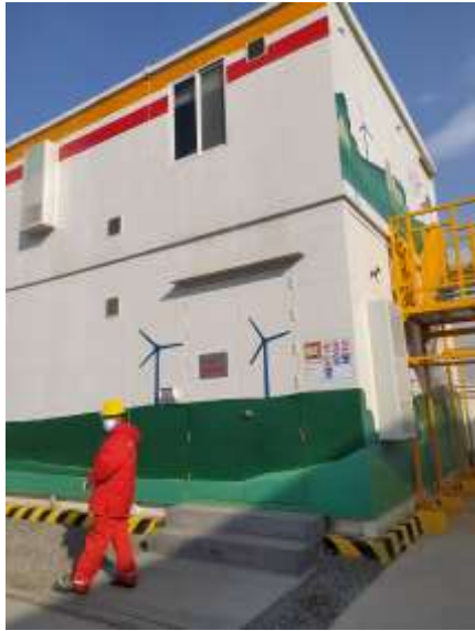
图 4-10 升压站主控室
