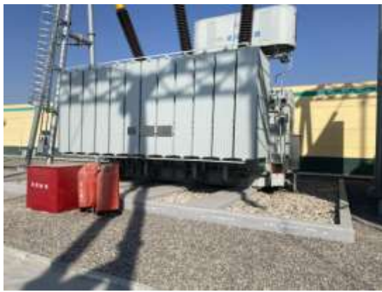
1#主变及贮油坑
