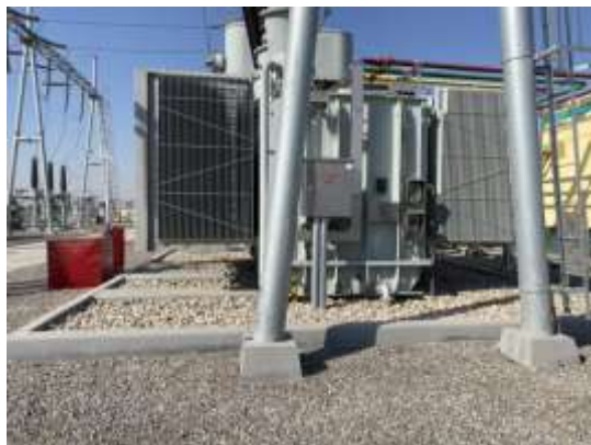
2#主变及贮油坑
