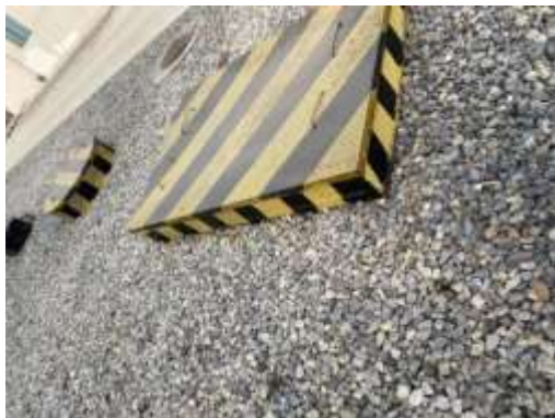
升压站内事故油池
