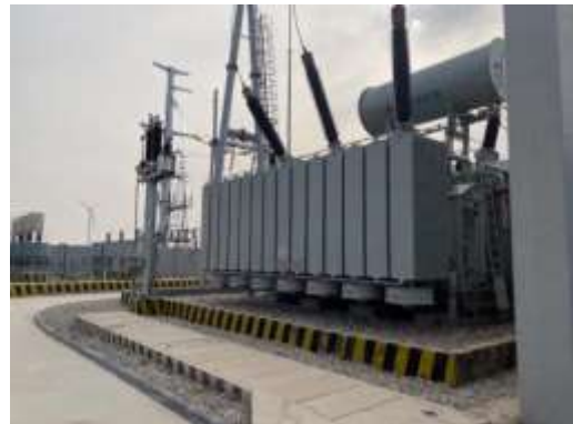
2#主变及贮油坑
