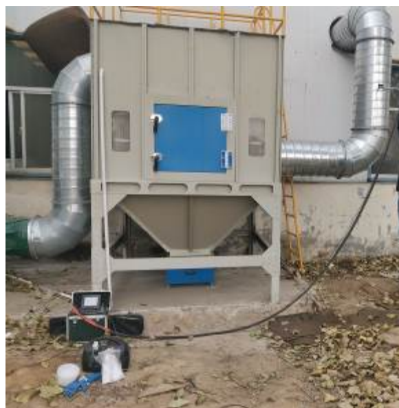
火焰切割废气粉尘处理
