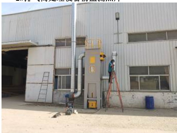
3#排气筒处理设备前监测照片
