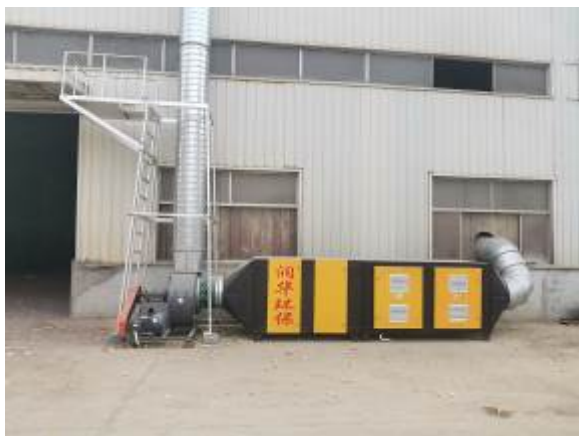
涂漆废气处理设施
