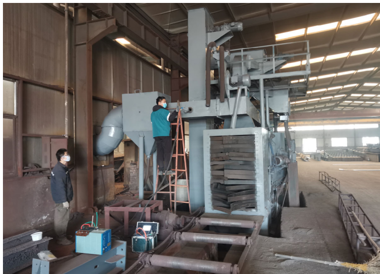
2#排气筒处理设备前监测照片
