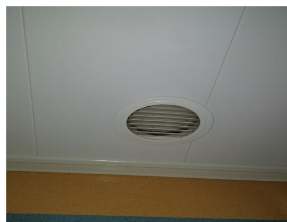
机房内排风口
