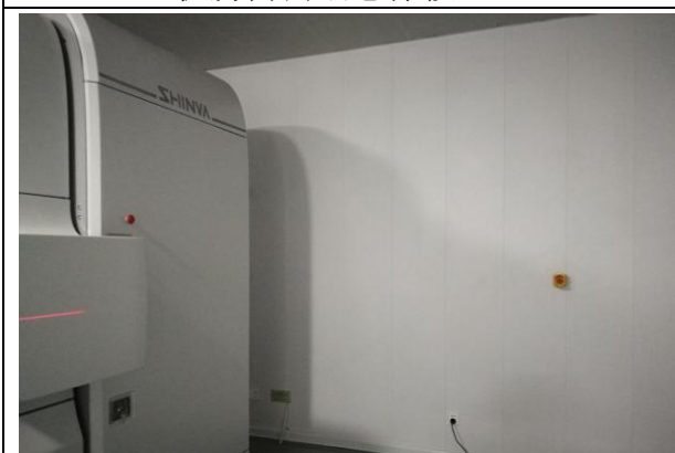
机房内南墙急停按钮 2
