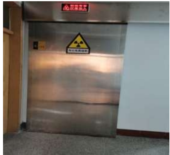
PCT CT 室防护门
